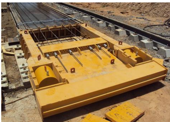
Figura 1.27 – Estrutura metálica para fixação (ancoragem) de fios ou cordoalhas de protensão na extremidade ( ancoragem passiva ) de uma pista de protensão (a fixação na travessa metálica da estrutura de reação ocorre por meio de cunha embutida em porta-cunha). (Fonte: Weiler-C.Holzberger Ind. Ltda, http://wch.com.br )
