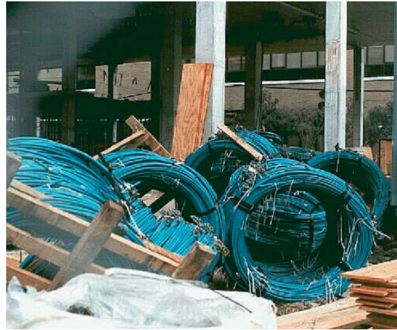
Figura 3-6 Má condição do estoque na obra dos cabos cortados
