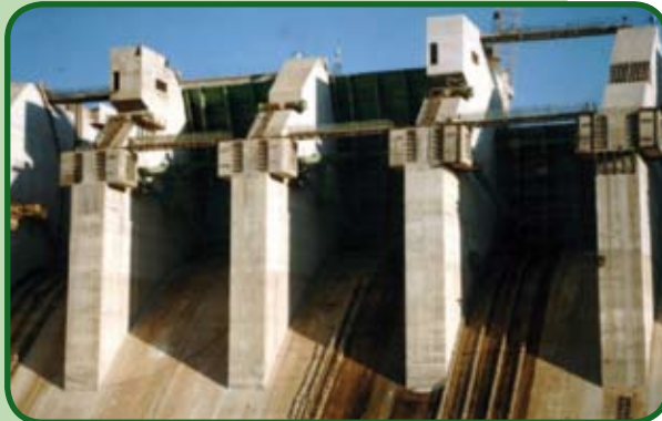
UHE Mascarenhas de Moraes, Ibiraci - MG. Estruturas seguras e resistentes aos elevados esforços incidentes nestes elementos.
