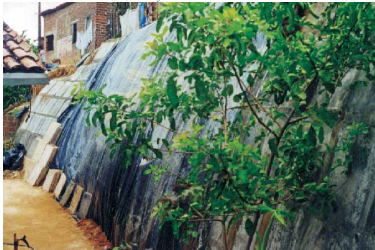
TALUDE SUBVERTICAL COM QUEDA DE LAJOTAS Sítio dos Pintos, Recife
