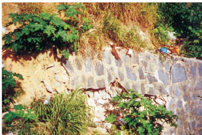
MURO de ARRIMO em PEDRA RACHÃO parcialmente destruído Dois Carneiros - Ibura, Recife
