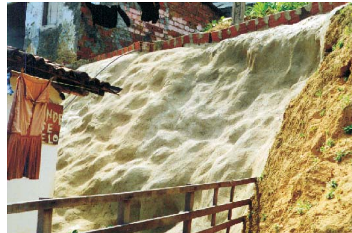
REVESTIMENTO PARCIAL sem SOLUÇÃO de DRENAGEM Dois Carneiros - Ibura, Recife
