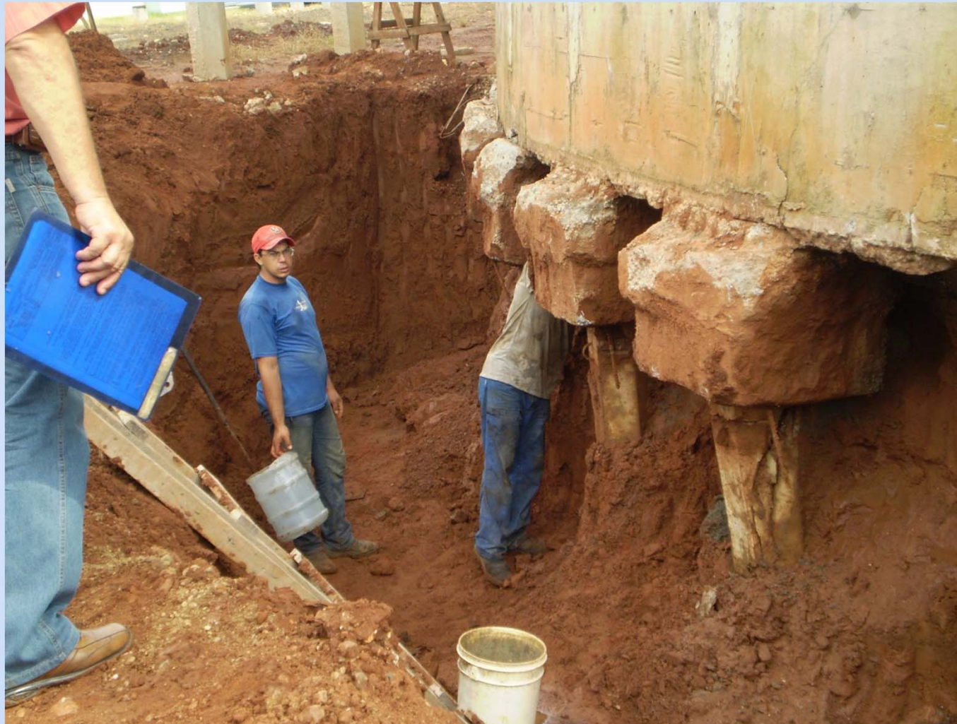
ESTACA PRÉ-MOLDADA ROMPIDA
