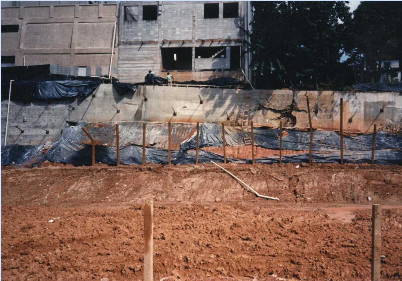
RUPTURA DE CORTINA ATIRANTADA COM ABALO DAS FUNDAÇÕES EM ESTACA DO EDIFÍCIO VIZINHO
