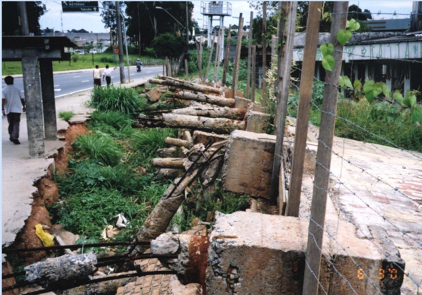
RUPTURA DO MURO DE ARRIMO
