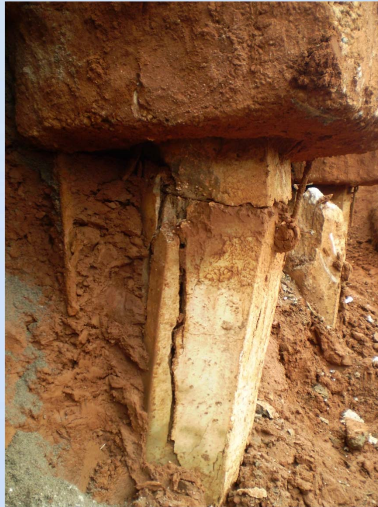
ESTACA PRÉ-MOLDADA ROMPIDA
