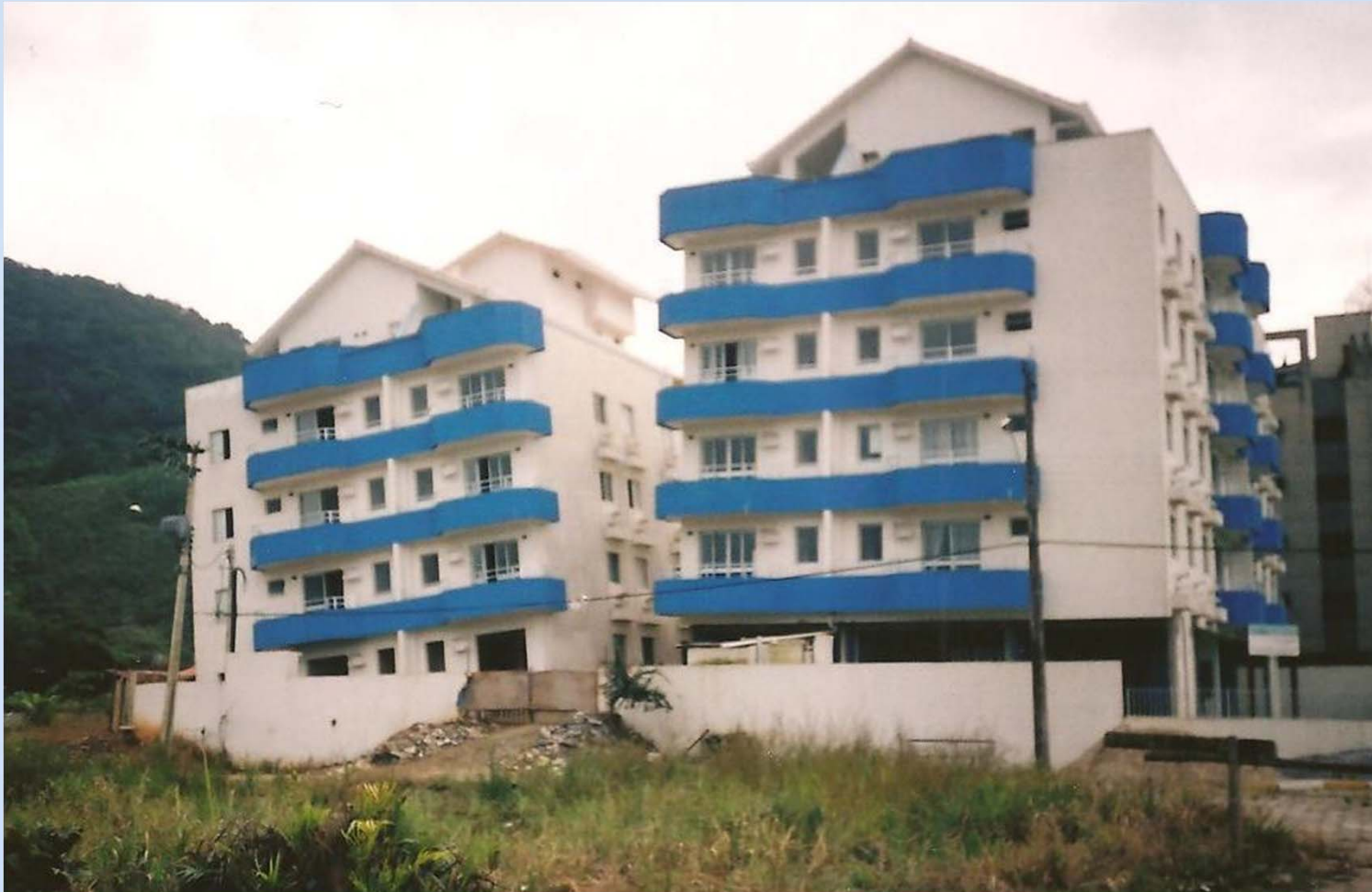
RUPTURA DAS FUNDAÇÕES
