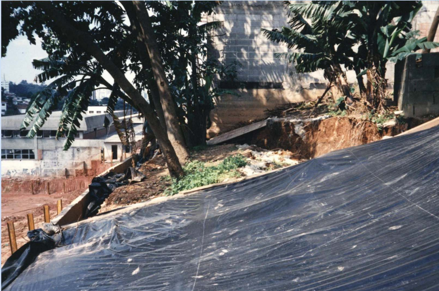
RUPTURA DE CORTINA ATIRANTADA COM ABALO DA EDIFICAÇÃO VIZINHA
