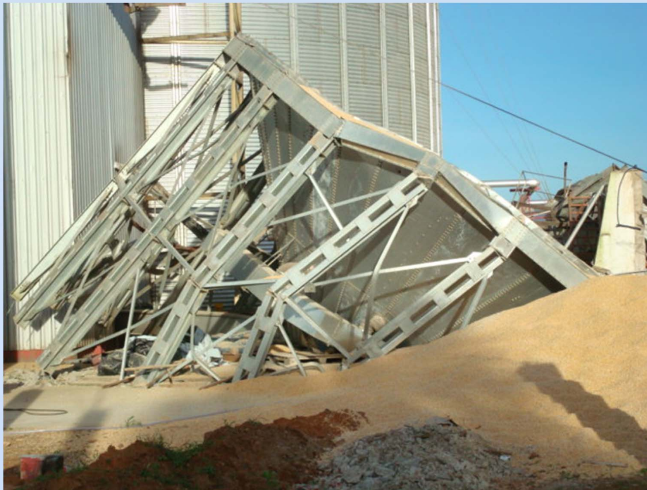
RUPTURA DAS FUNDAÇÕES EM ESTACAS DE UM SILO DE GRÃOS
